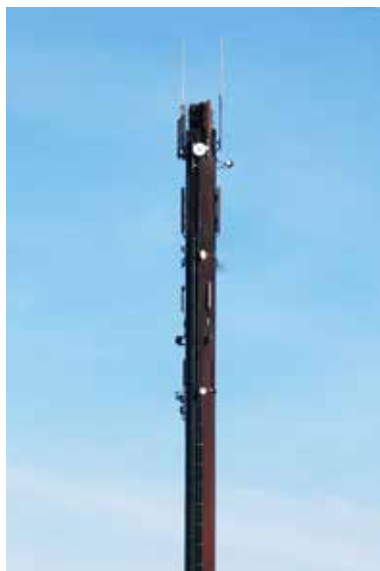
Antenner monteret på skorsten
