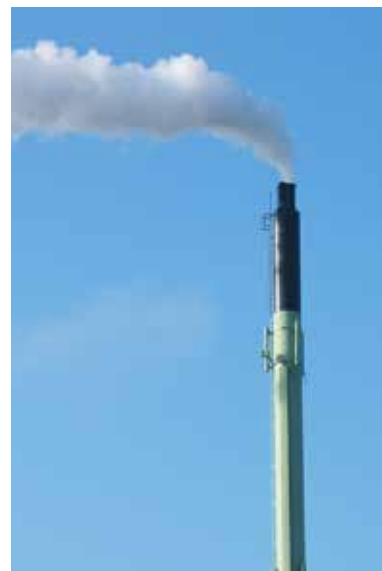
Antenner monteret på skorsten
