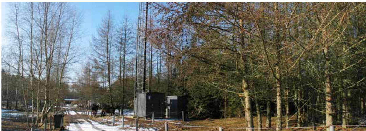
En anonym placering - mast og teknikkabiner er skjult af skovens træer og kan først ses, når man er helt tæt på.
