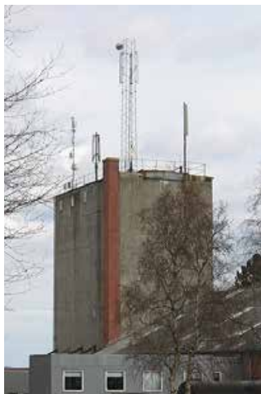
Mast/antenner placeret på bygning
