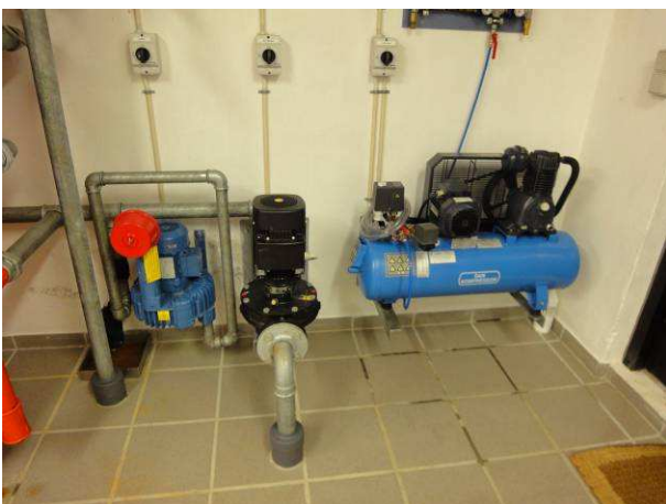
Returskylleanlæg og iltningsskylleanlæg
