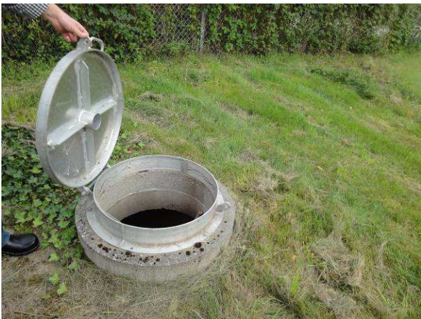
Adgang til bundfædningsbeholder
