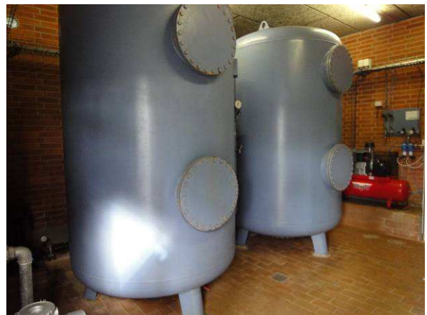
Forfilter og efterfilter, i baggrunden iltningsskæmmer
