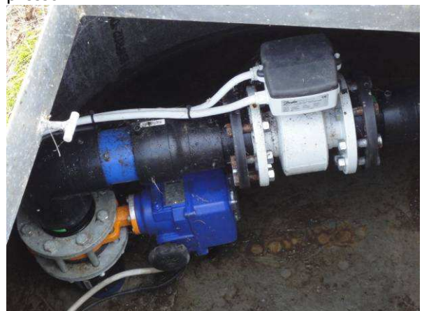
Motorventil til styring af råvandstilgang
