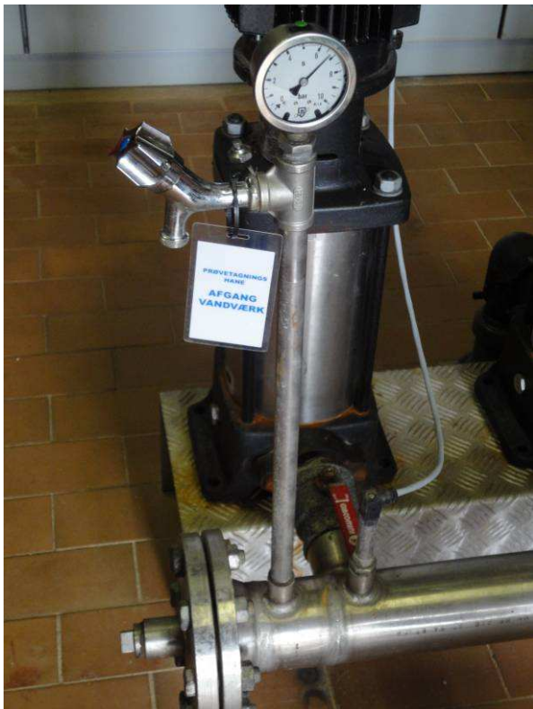
Del af pumpe til højtrykszone og prøvehane på afgang vandværk
