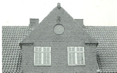
Gavl med skråtmurede strømskifter på hovedbygningen til Djurslands Landboforening, Grønland 24. God håndværkermæssig løsning på gavlafslutningen.
