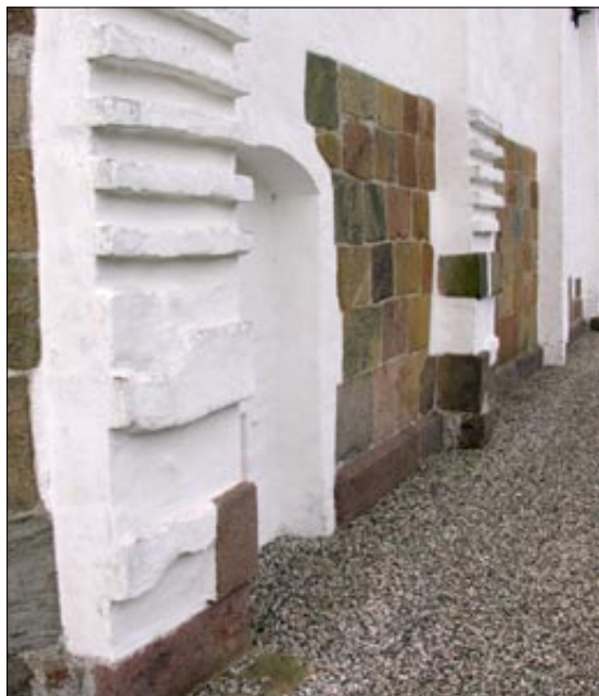
Oprindelige romanske kvadrer i kirkens nordside og den tilmurede dør til det sakristi, der aldrig blev bygget færdigt.
