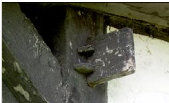
En af de mange gamle bygningsdetaljer på Karbygård: gennemstikning fastholdt med to tværgående dyvler.
