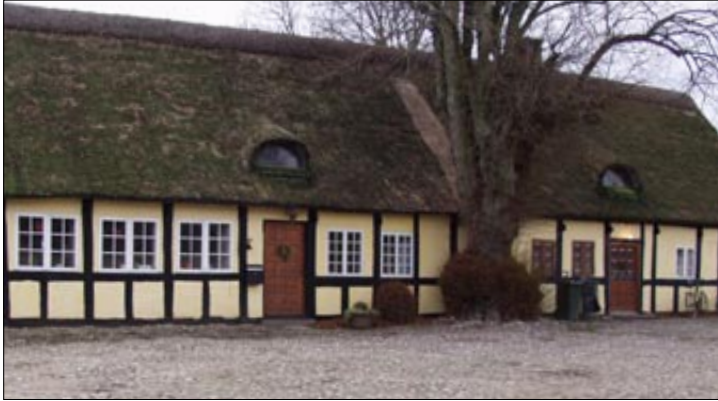
Stuehuset til Voldbygård. Gårdspladsens fine stenbelægning er med til at understrege det statelige ved den gamle gård hvis skæbne i perioder har været knyttet til Voldby kirke (jvf. tidligere).
